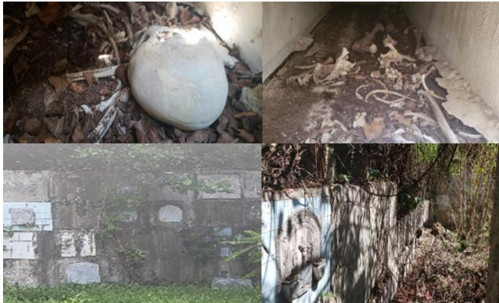
Figura 16. Daños recurrentes en las bóvedas y tumbas del Cementerio de Bailey.
