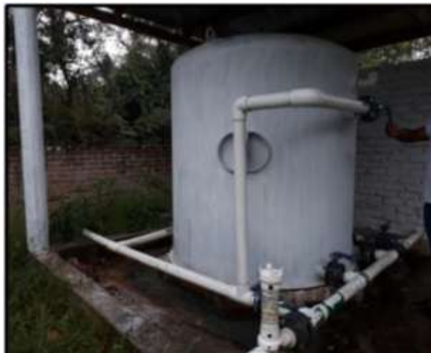
Figura 3. Sistema de floculación fuera de servicio
