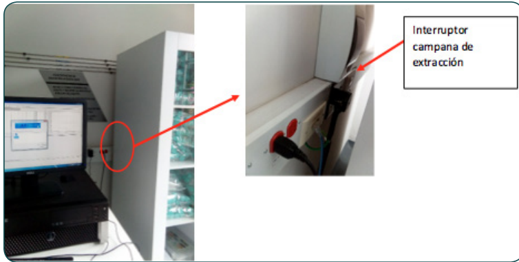
Figura 6. Interruptor del sistema de extracción.
