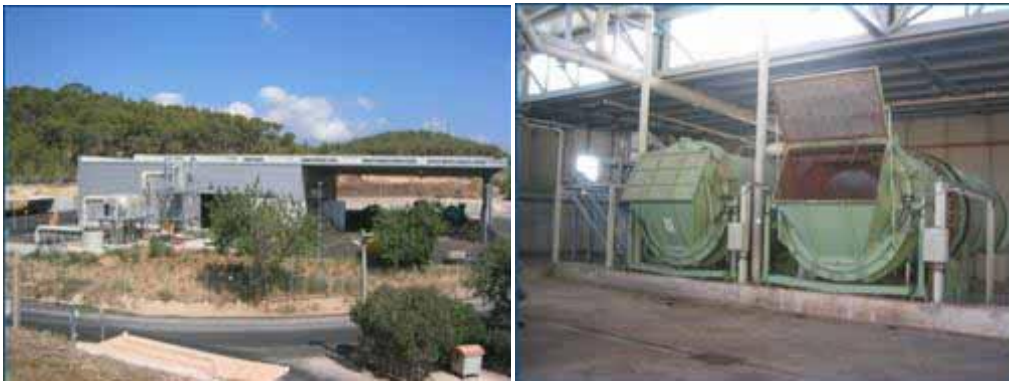
Figura No. 4 Planta de compostaje en tambores para residuos orgánicos en Calvià, Mallorca; capacidad 5.000 t/a
