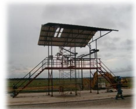
Zona para cargue de crudo
