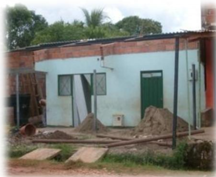
Postes para casas
