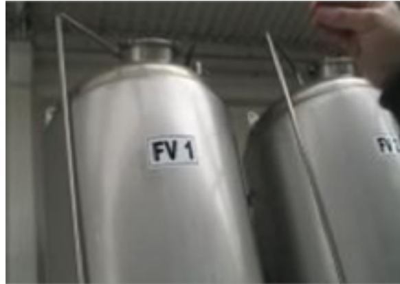
Figura 38. Tanques de fermentación y maduración en la cervecería Artesanal “Las tres Marías”
