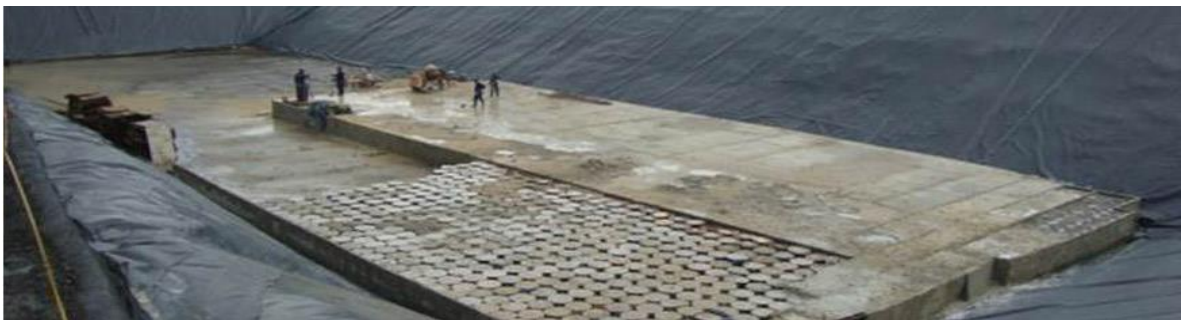
Figura 12 Celda de seguridad Fuente (Tecniamsa S.A ESP, 2013)
