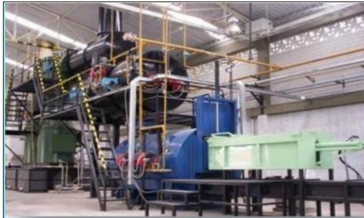
Figura 7. Termodestrucción controlada Fuente (Ecocapital Internacional S.A ESP)
