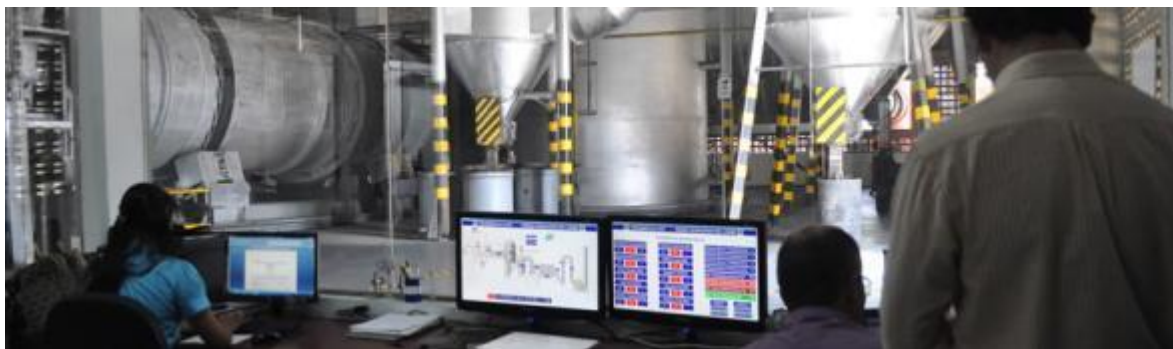
Figura 11. Hornos incineradores y monitoreo del proceso. Fuente (Tecniamsa S.A ESP, 2013)
