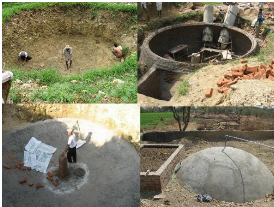
Figura 18. Planta de Biogás de Domo Fijo.
