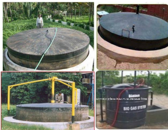
Figura 15. Planta de Biogás tipo Campana Flotante de Gas.
