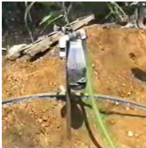
Figura 27. Válvula de seguridad instalada para el Biodigestor Taiwán o Estructura Flexible
