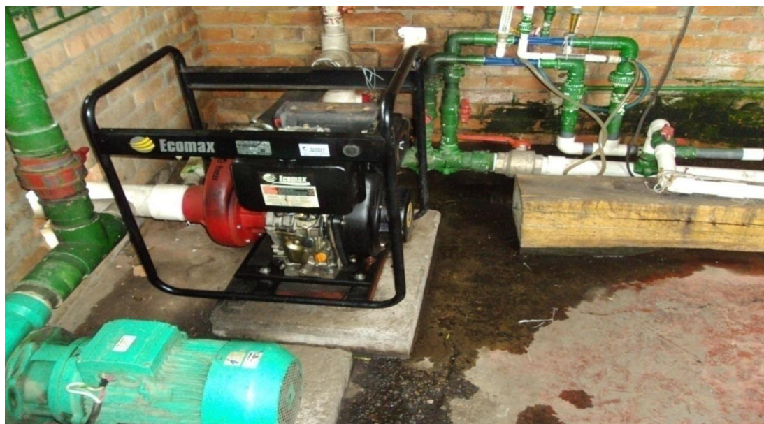
Figura 44 - Sistema de Bombas
