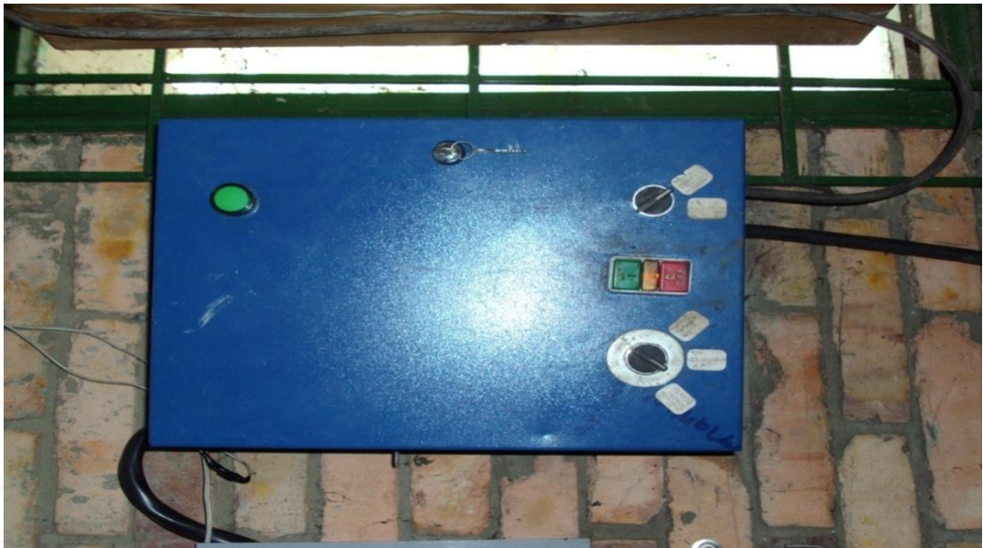
Figura 46 - Sistema de Motobombas Eléctrico
