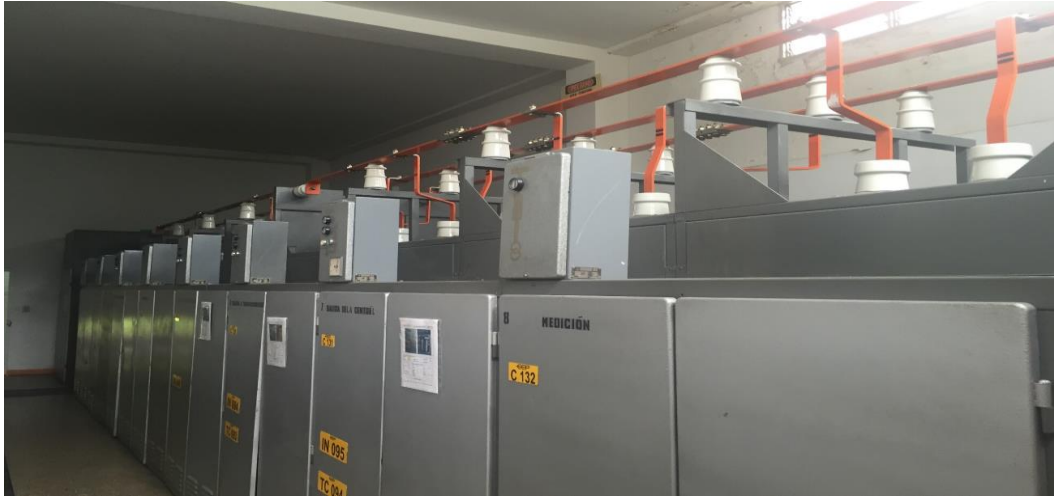
Figura 34. Unidades de conexión generación-Distribución Libaré
