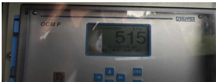
Figura 33. Tablero control de caudal EEP
