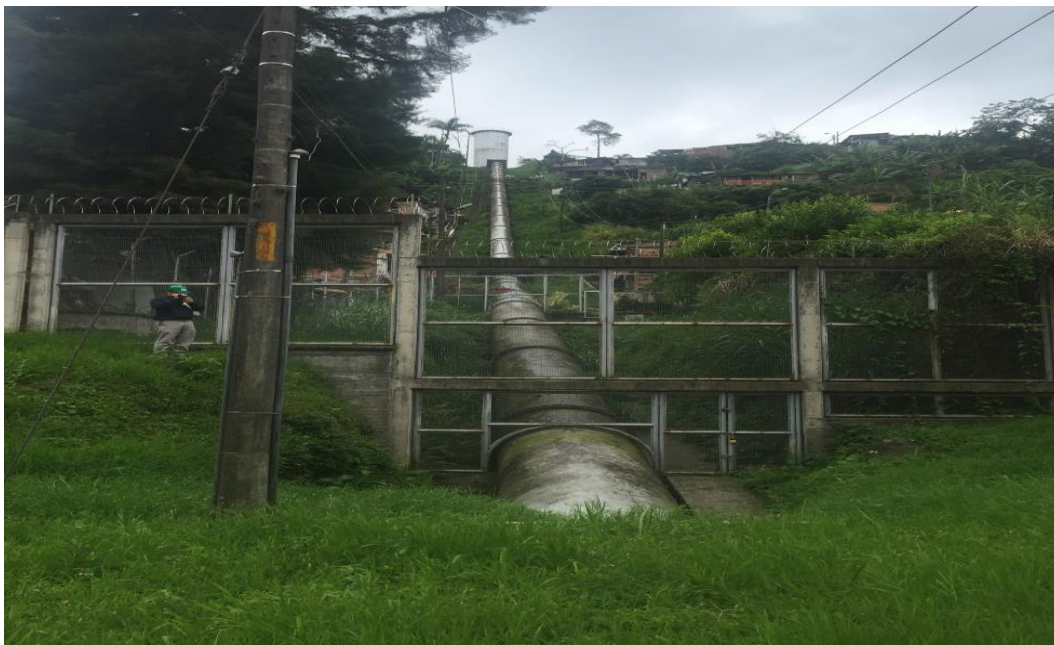
Figura 35. Tubería de Presión Planta Libaré.
