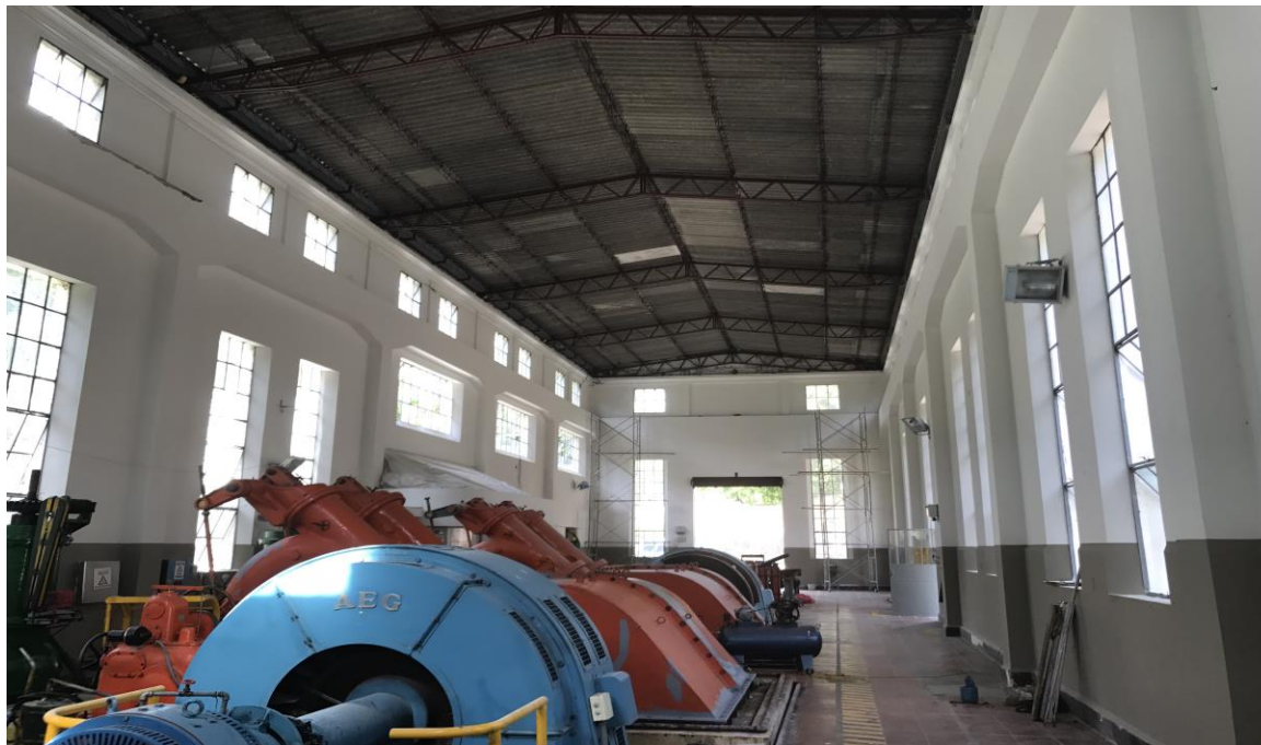
Figura 30. Planta de generación Belmonte
