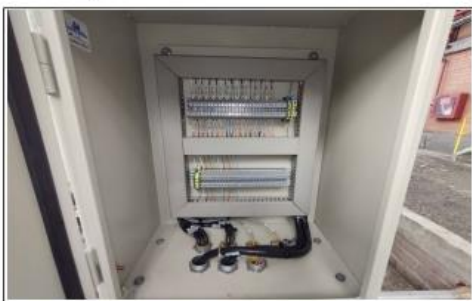
Foto 3 Montaje de Facilidades electricas para Dosificacion Lisina
