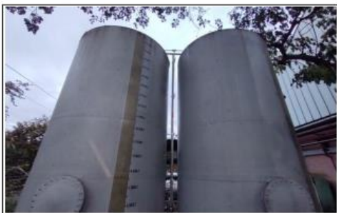
Foto 7 Montaje de Facilidades electricas para Dosificacion Lisina
