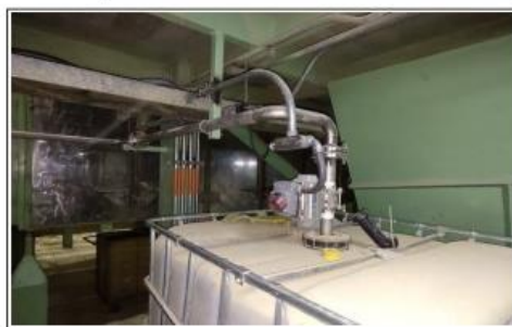
Foto 17 Montaje de Facilidades electricas para Dosificacion Lisina
