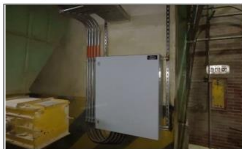
Foto 18 Montaje de Facilidades electricas para Dosificacion Lisina
