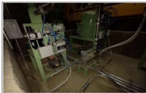
Foto 13 Montaje de Facilidades electricas para Dosificacion Lisina
