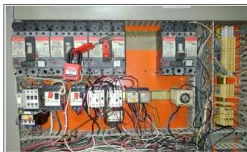
Foto 2 Bloqueo y Etiquetado de Energías Peligrosas
