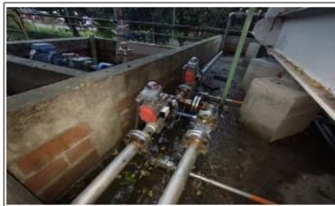
Foto 10 Montaje de Facilidades electricas para Dosificacion Lisina
