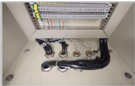
Foto 1 Montaje de Facilidades electricas para Dosificacion Lisina
