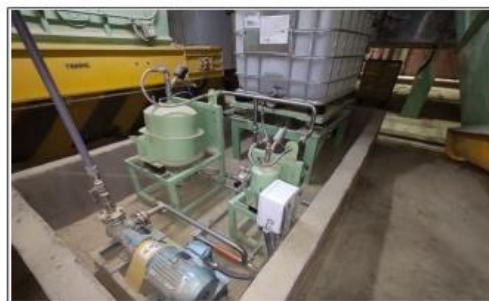
Foto 16 Montaje de Facilidades electricas para Dosificacion Lisina
