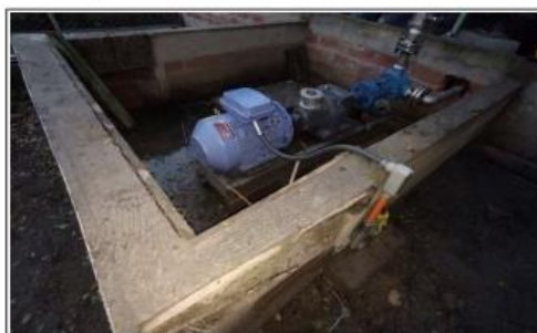
Foto 6 Montaje de Facilidades electricas para Dosificacion Lisina
