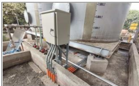
Foto 4 Montaje de Facilidades electricas para Dosificacion Lisina
