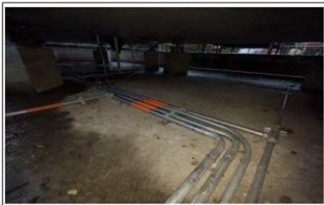
Foto 9 Montaje de Facilidades electricas para Dosificacion Lisina
