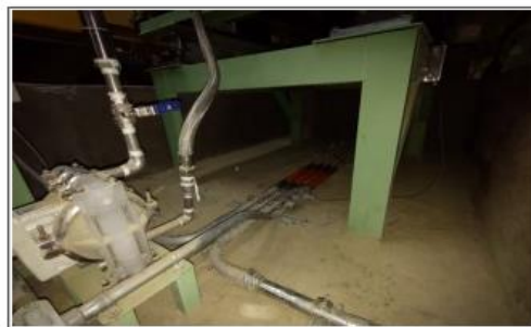
Foto 14 Montaje de Facilidades electricas para Dosificacion Lisina
