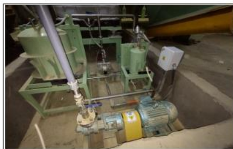
Foto 15 Montaje de Facilidades electricas para Dosificacion Lisina
