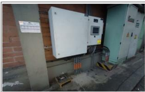
Foto 11 Montaje de Facilidades electricas para Dosificacion Lisina
