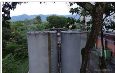
Foto 5 Montaje de Facilidades electricas para Dosificacion Lisina
