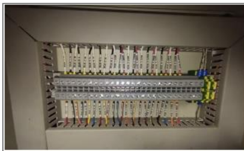
Foto 2 Montaje de Facilidades electricas para Dosificacion Lisina
