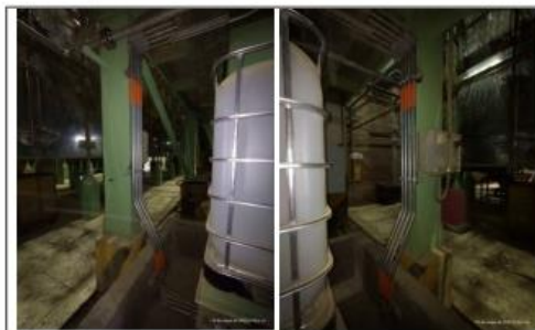
Foto 12 Montaje de Facilidades electricas para Dosificacion Lisina
