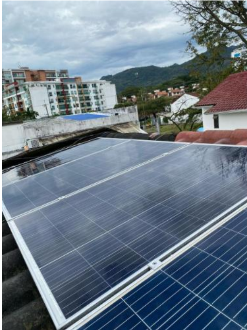
Paneles Solares Instalados
