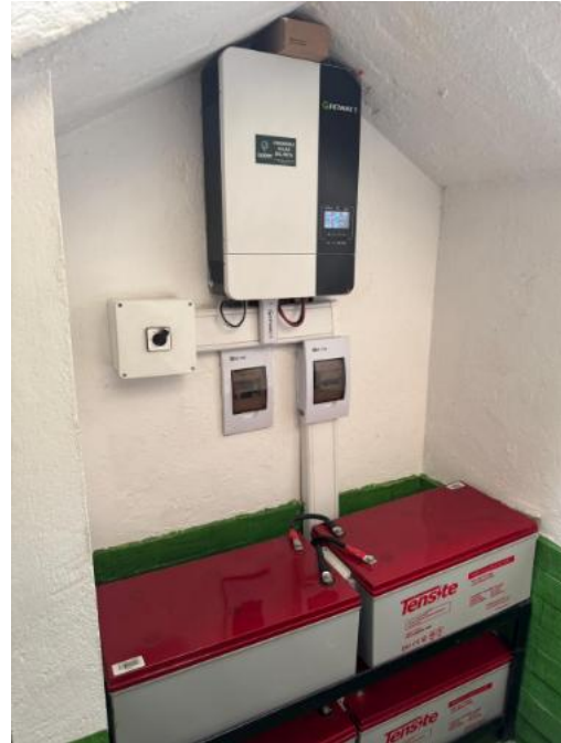
Baterías e Inversor
