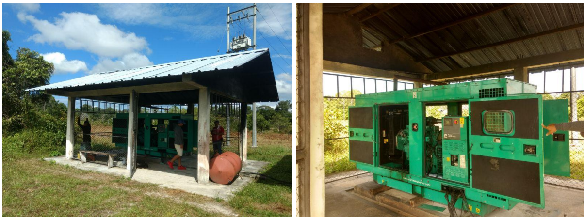
Figura 6: Unidades de generación Diesel en áreas Rurales Fuente: Instituto de Planeación y Planificación de Soluciones Energéticas IPSE
