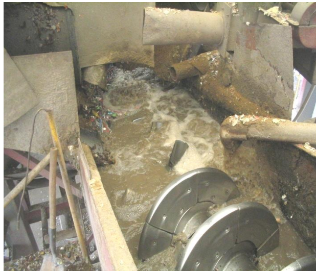
Figura 11. Trituración y lavado (tornillo sin fin de acero inoxidable)
