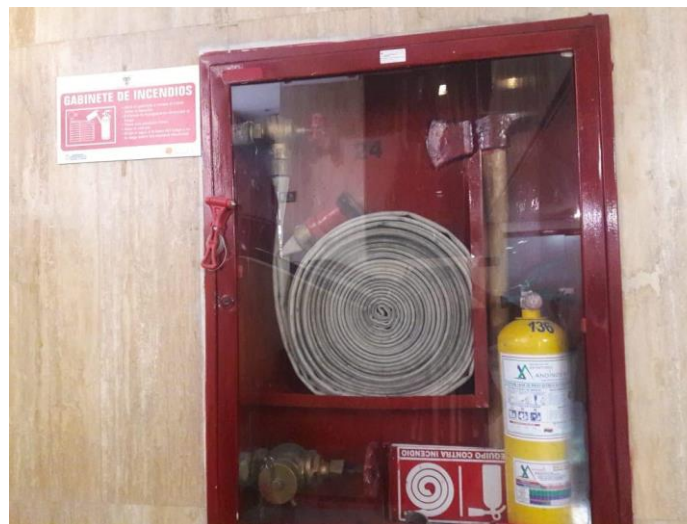
Figura 4 Gabinetes de incendios
