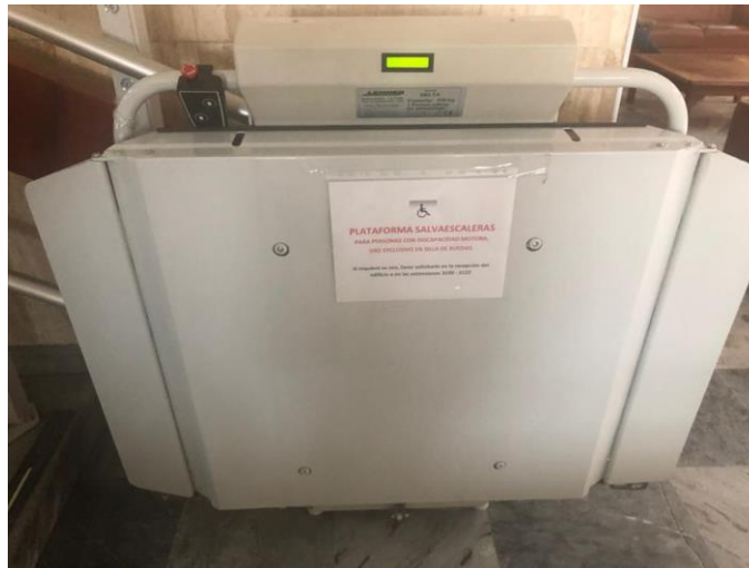
Figura 23 Plataforma escaleras discapacitados
