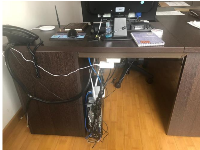
Figura 9 Puesto de trabajo con cableado poco biomecánico
