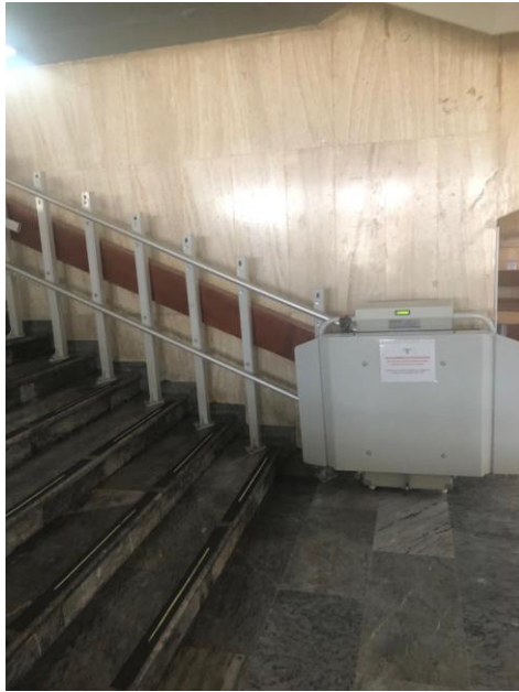
Figura 24 Plataforma escaleras discapacitados 2
