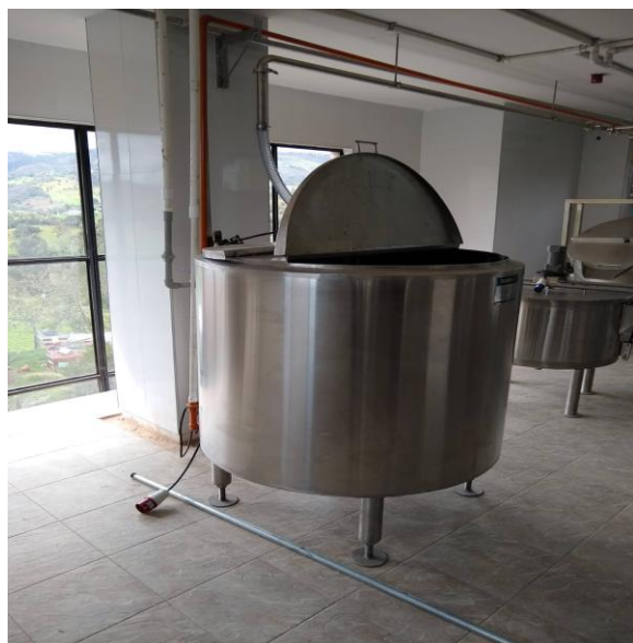
Imagen No. 9 Equipo de enfriamiento
