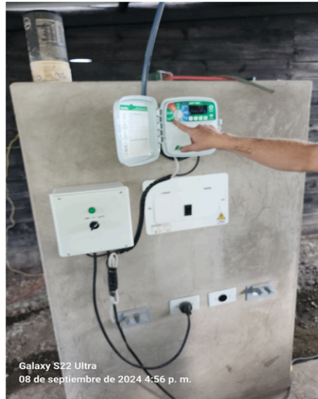
Ilustración 7. Controlador del sistema de riego de la finca Villa María.
