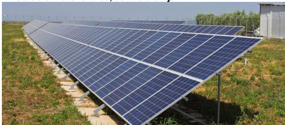
Figura 31. Instalación fotovoltaica, estructura fija
