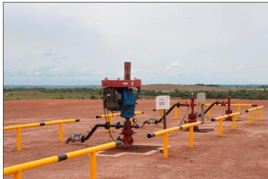
Fig 4. Facilidades de superficie para extracción
