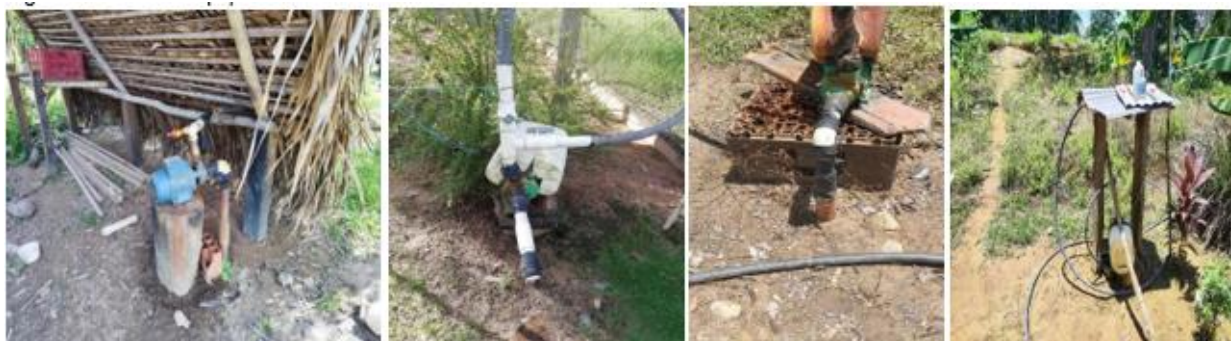
Ilustración 14 Estado equipos de bombeo beneficiarios
