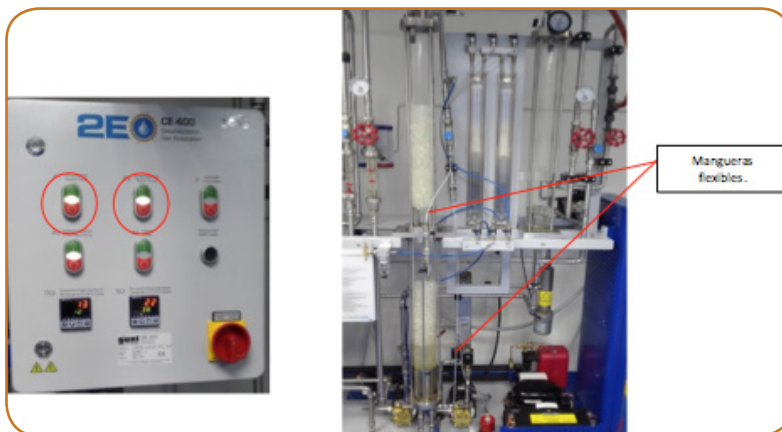
Figura 13. Interruptores P1 y P2 de llenado Columna de Absorción K1 y Columna de Regeneración K2.
