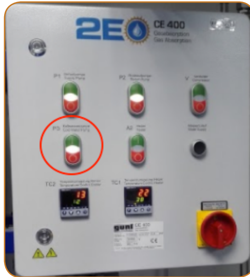
Figura 12. Interruptor de bomba de agua refrigerante P3.
