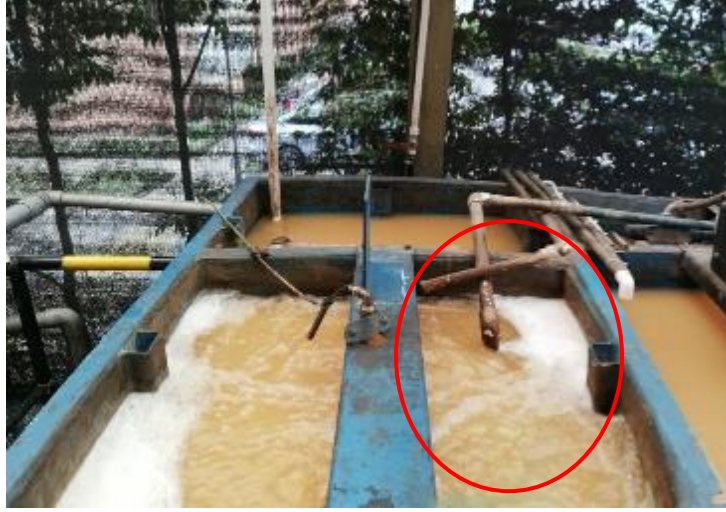
Imagen 9. Tanque de estabilización de pH - señalado en el círculo rojo
