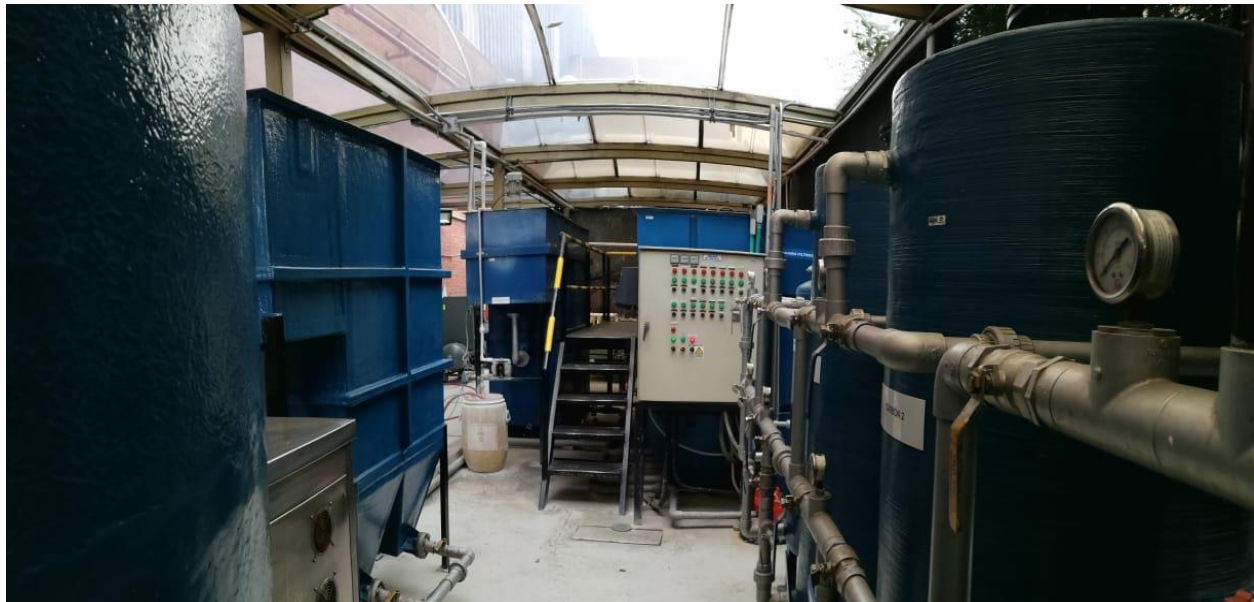
Imagen 2. Vista general de la PTAR objeto de estudio
