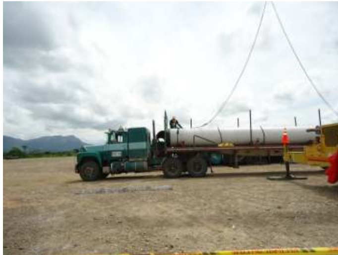
Figura No. 44. Camión transportando tubos desde el puerto (tubería importada), Oleoducto Bicentenario, (2012).
