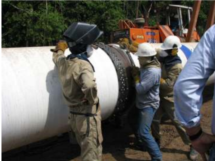
Figura No. 55. Montaje de la máquina orbital sobre la tubería que será soldada, Oleoducto Bicentenario, (2011).
